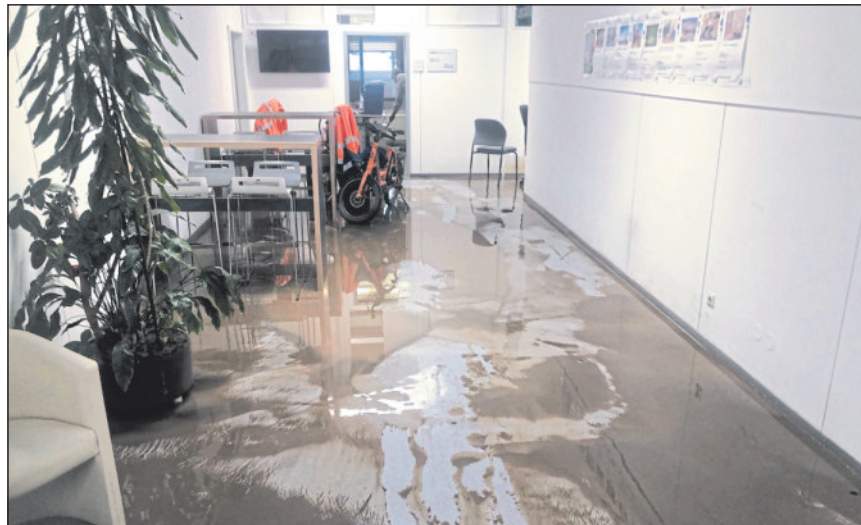
Eingang des VHS-Seminargebäude Wiesenstraße am Morgen des 3. Juni nach Abfluss des Hochwassers. Foto: vhs
