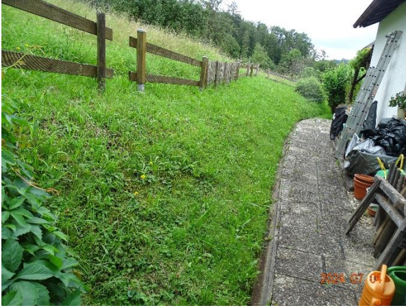
Abb. 7 Böschung hinter dem Einfamilienhaus mit darunter liegendem Regenablauf (roter Pfeil)
